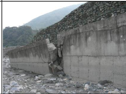
5 陳有蘭溪旁的破裂堤防
